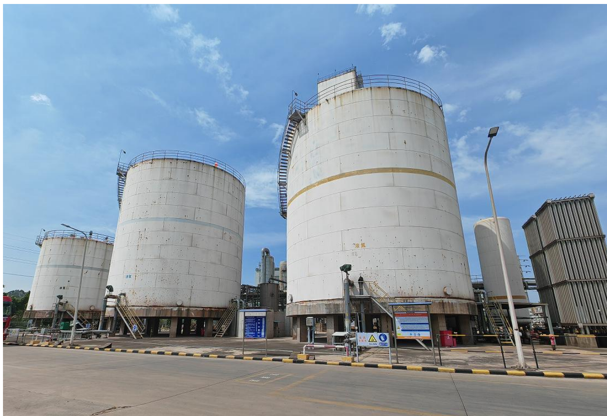
1#空分制氧站储罐区
